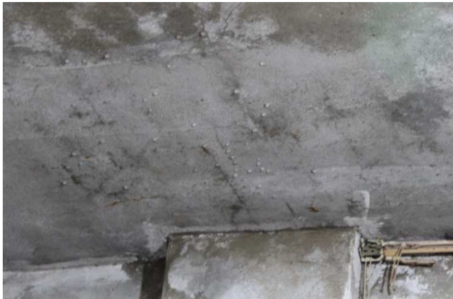
Lekkend plafond in een tweekamerwoning. (Burj el-Barajneh)
